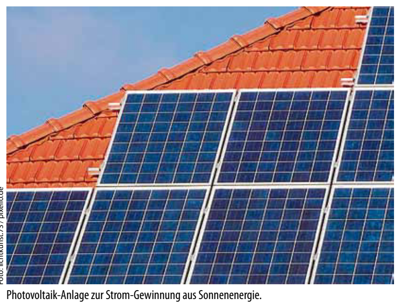
Photovoltaik-Anlage zur Strom-Gewinnung aus Sonnenenergie.
